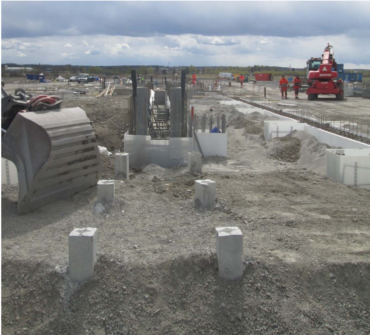
Grund och fundament för tågserviceanläggningen i riktning mot söder. Hallen kommer bli drygt 120m lång och mitt i bild syns formen för lokarbetsplatsens inspektionsgrav som kommer att gutas inom kort.
